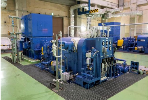
ごみ焼却熱発電 5,000kW
