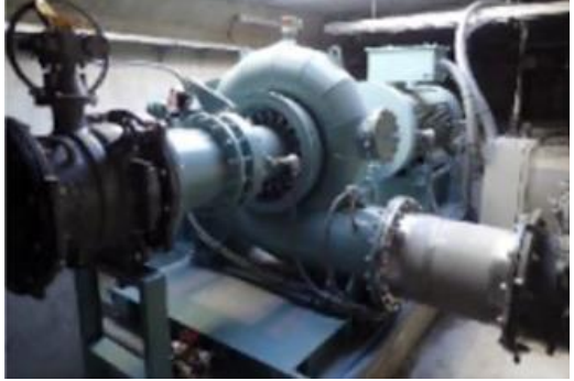
浄水場小水力発電 233kW
