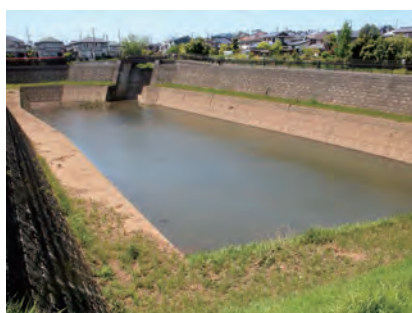
上新井調節池
