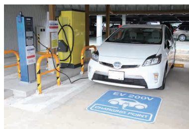
電気自動車充電インフラの整備
