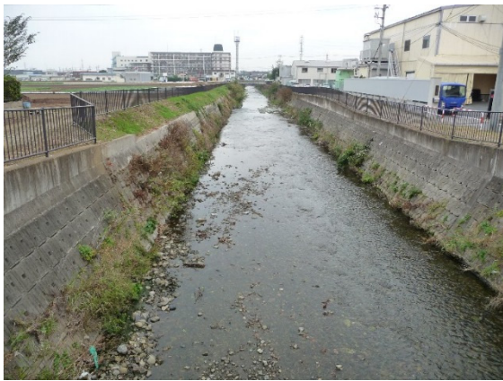
河床には礫や土砂が堆積している
