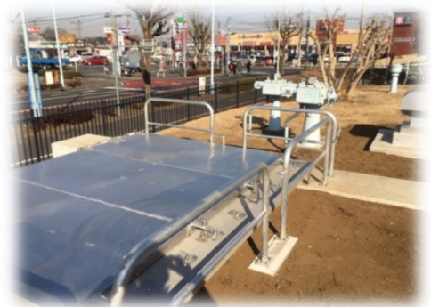
小水力発電設備(地上)
