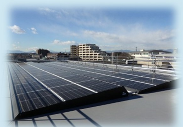
庁舎屋上の太陽光パネル
