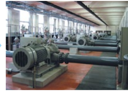
⑤配水ポンプ ポンプで市内の家庭や学校に水を送る。
