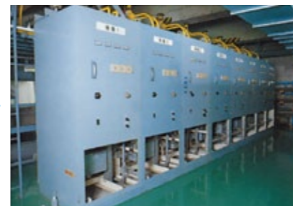
④消毒設備 消毒剤(次亜塩素酸ナトリウム)で消毒・滅菌するための設備。
