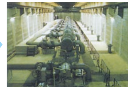
⑥送水ポンプ このポンプで、所沢市などの市町村へ水道水を送り出す。
