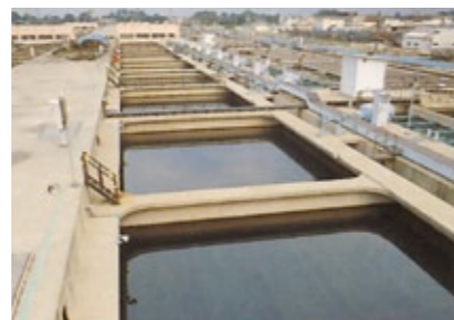
③急速ろ過池 水を砂の層でこして、細かいゴミを取り除く。
